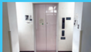
本館のエレベータ (緊急用)
